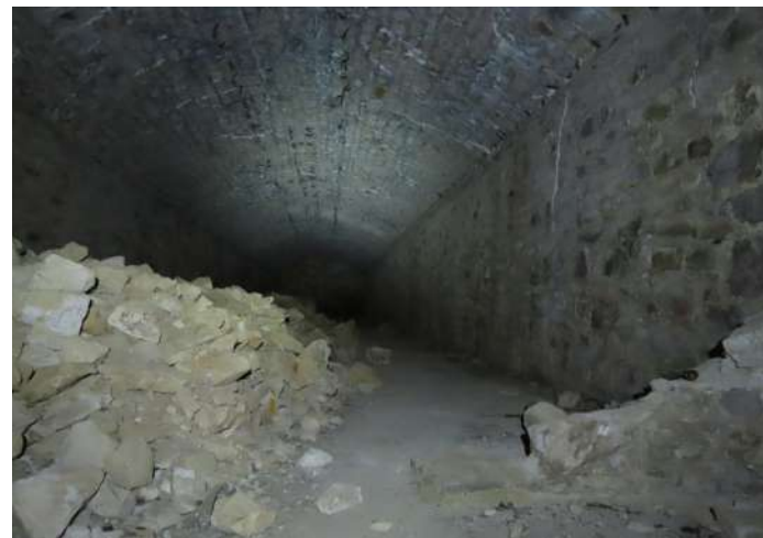
Fig 21: Photo chambre souterraine avec cloison détruite.
